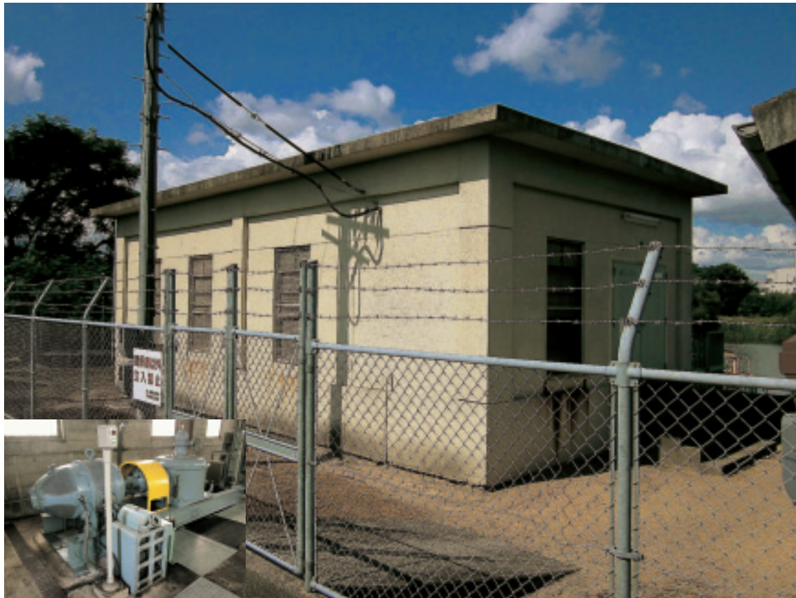
「藤田三角地機場」の建屋とその内部（10頁に詳細解説）
