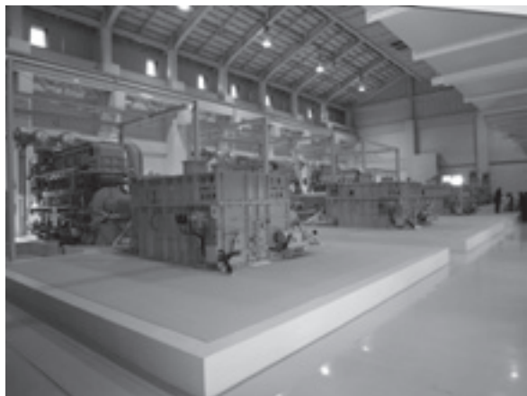
巨椋池排水機場の内部
