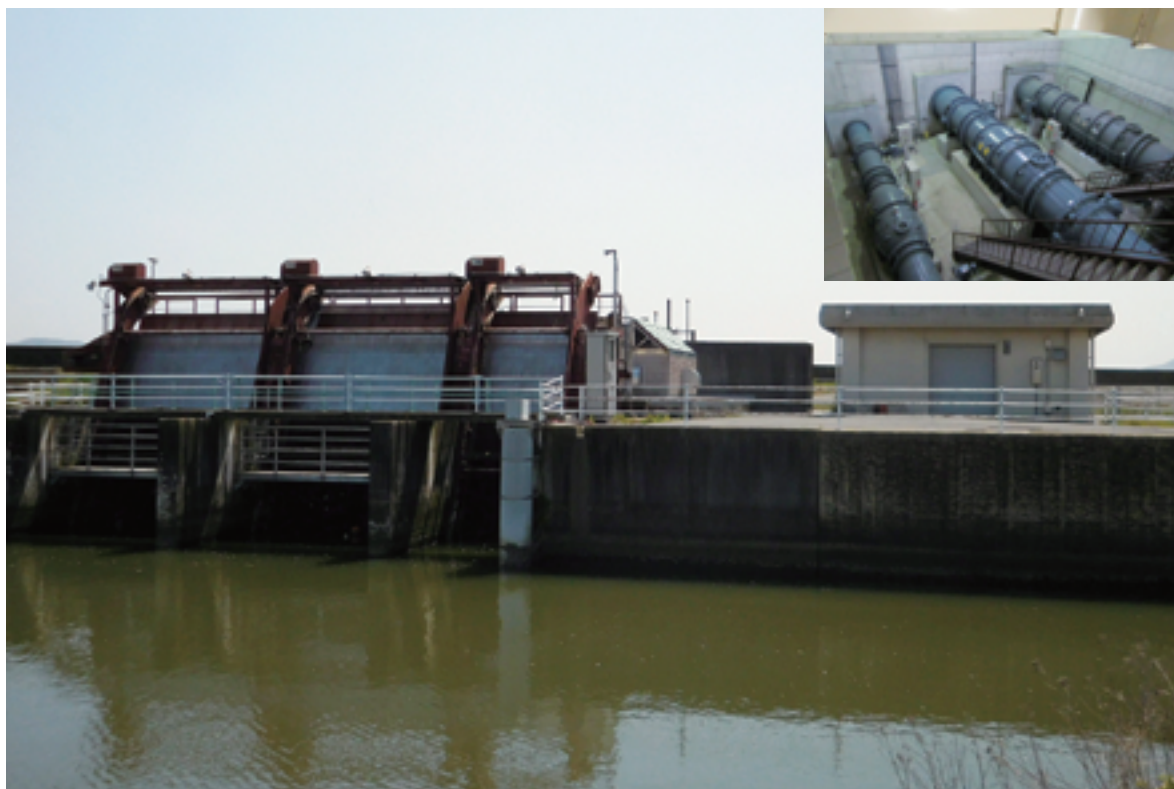
「浦安東機場」の建屋とその内部（9頁に詳細解説）
