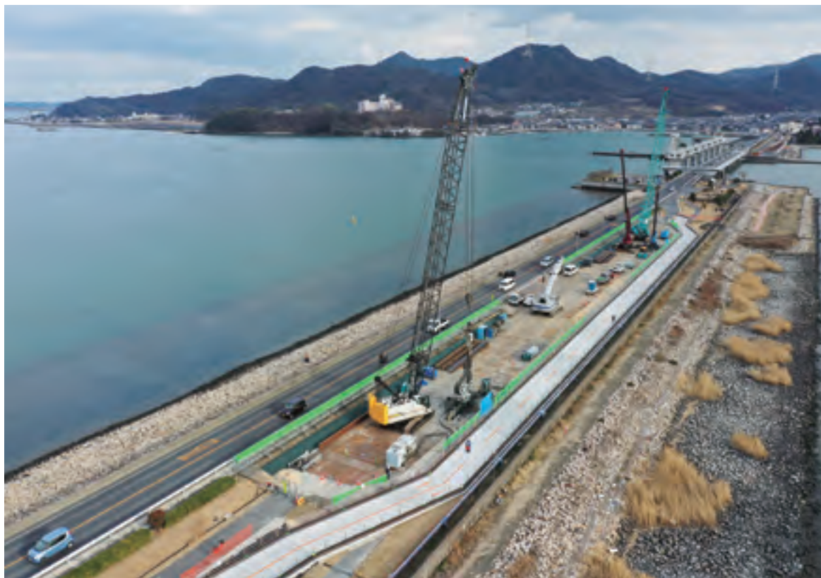
国営総合農地防災事業「児島湾沿岸地区」二重鋼矢板設置工事の様子
